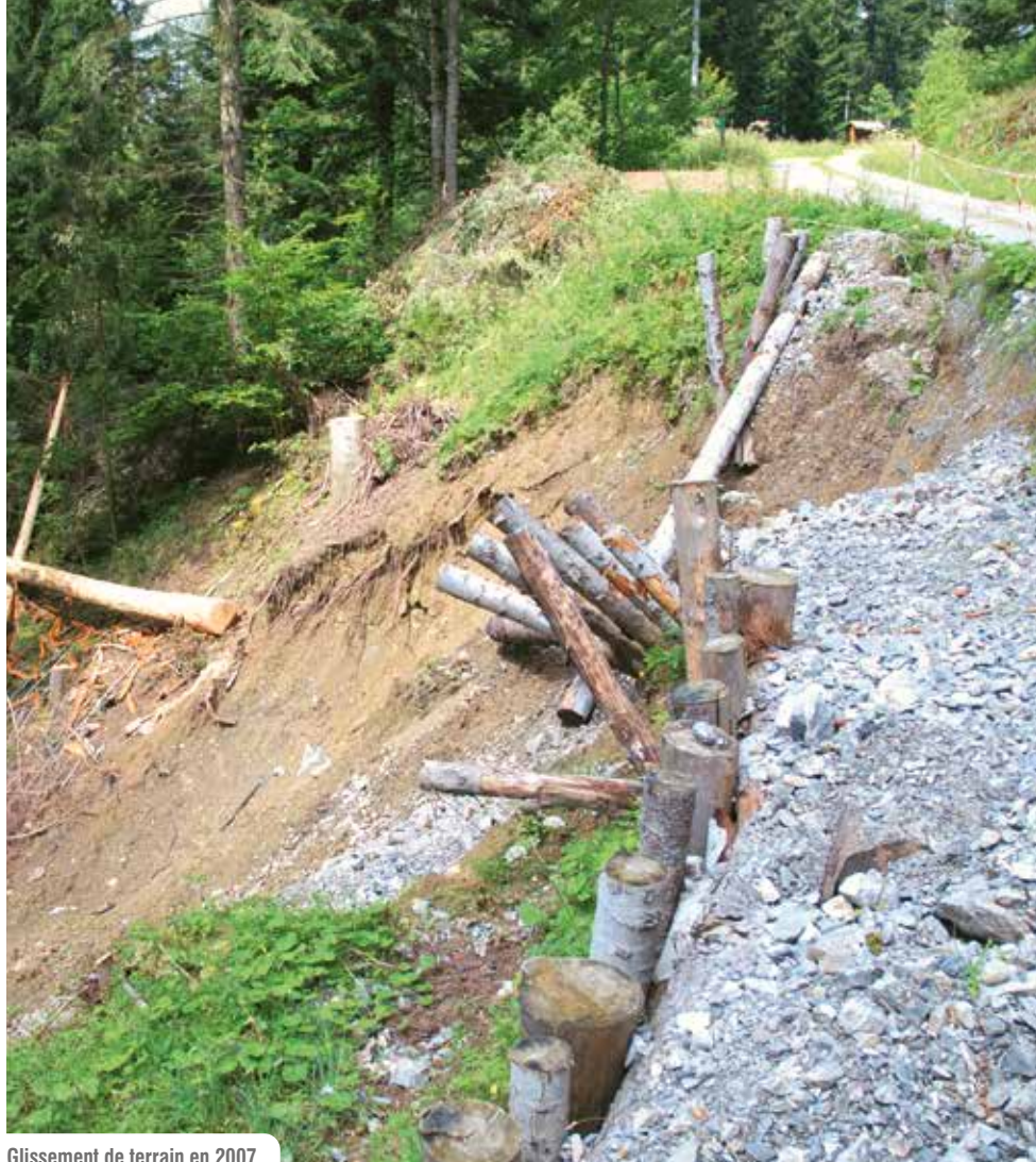
Glissement de terrain en 2007
